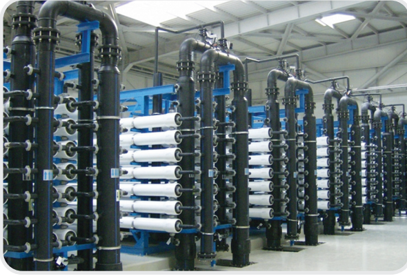
1360 MW Eren Enerji Zonguldak
